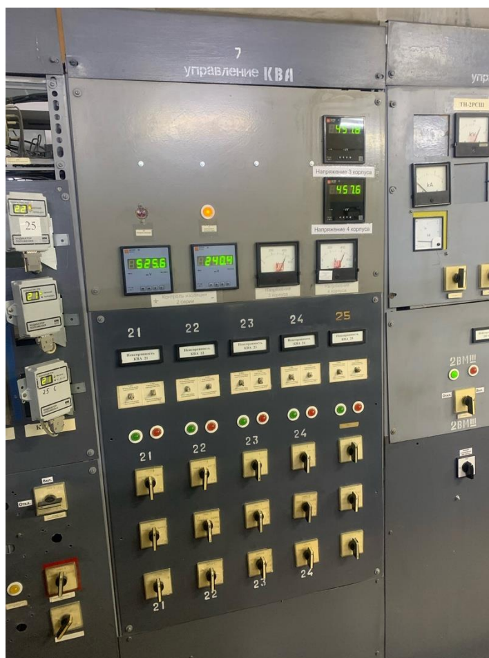
Рисунок 2.1 – Шкаф управления КВА
